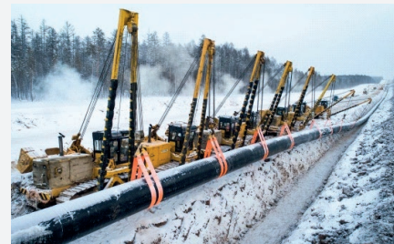
Магистральный газопровод Сила Сибири
